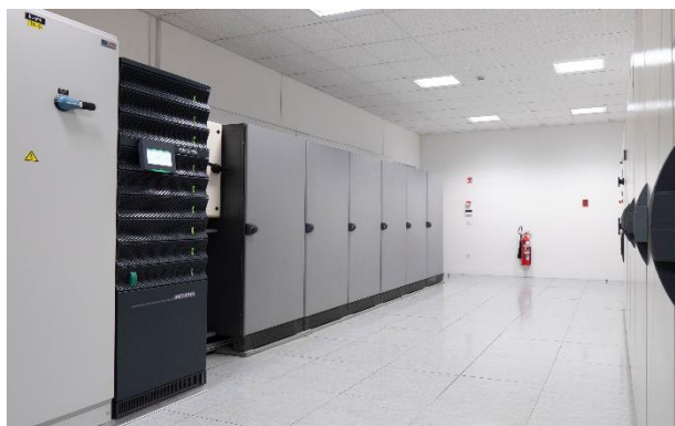
Slika 3: 600 kVA UPS v podjetju STN storitve d. o. o. [3]
