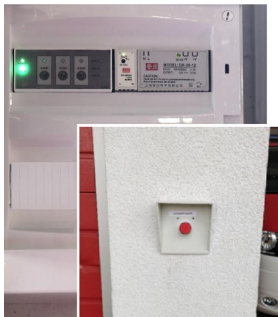
Slika 7: Naprava IntP v električni omarici in tipka pred garažo gasilskega doma.
